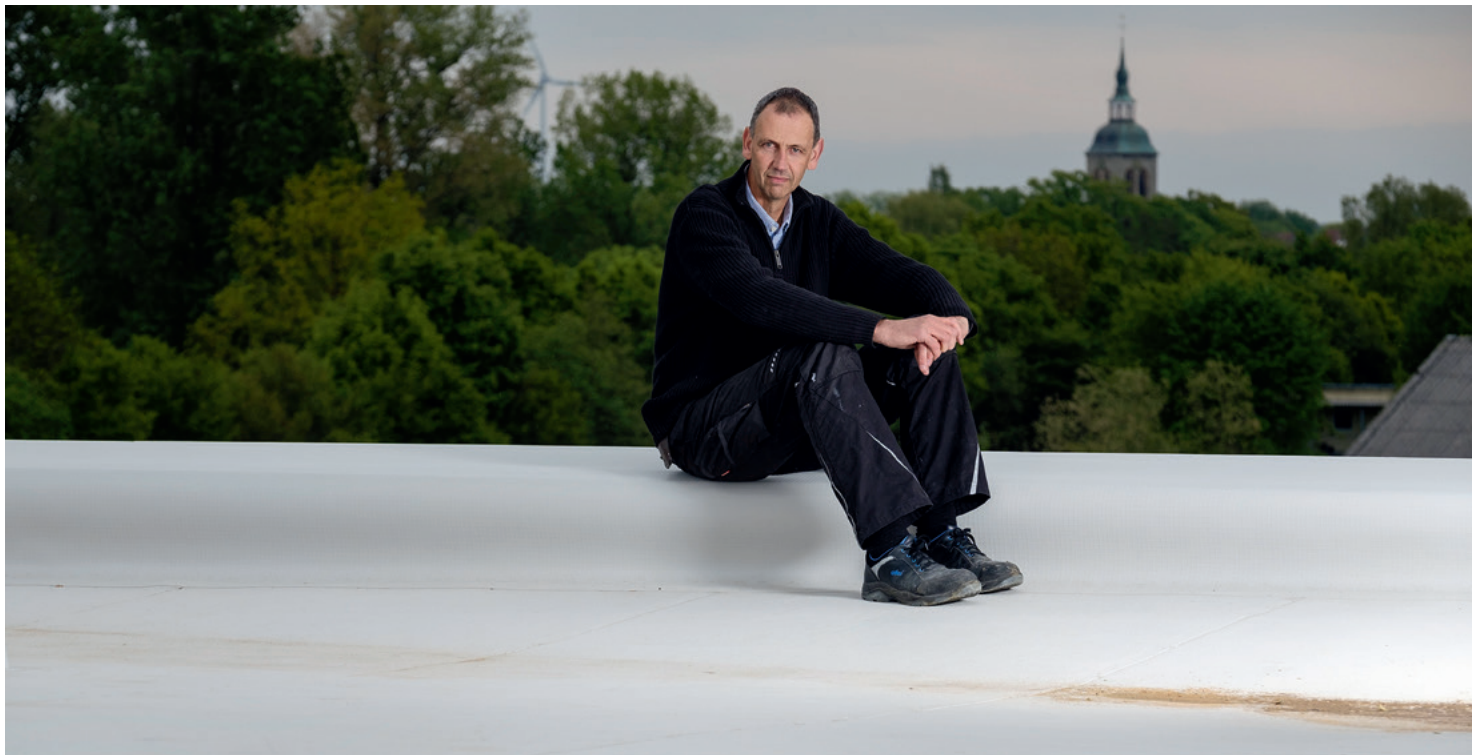
Schnee im Mai? Nein. Dachdeckermeister Hermann Harms sitzt nicht auf Schnee, sondern auf dem Absatz des weiss versiegelten Dachs der neuen Stadthalle.
